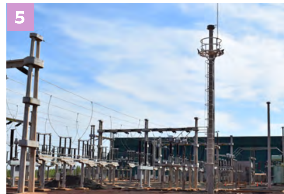
5 Estación transformadora y distribución a la red. Aquí se evalúa y ajusta los valores de energía requeridos por la red para entregarla al Sistema Argentino de Interconexión.
