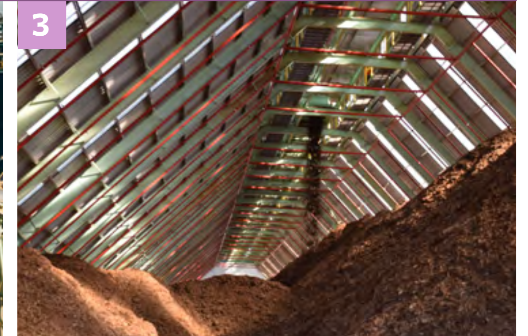
3 Silo. Ingresar el material en el silo con control de humedad y temperatura.
